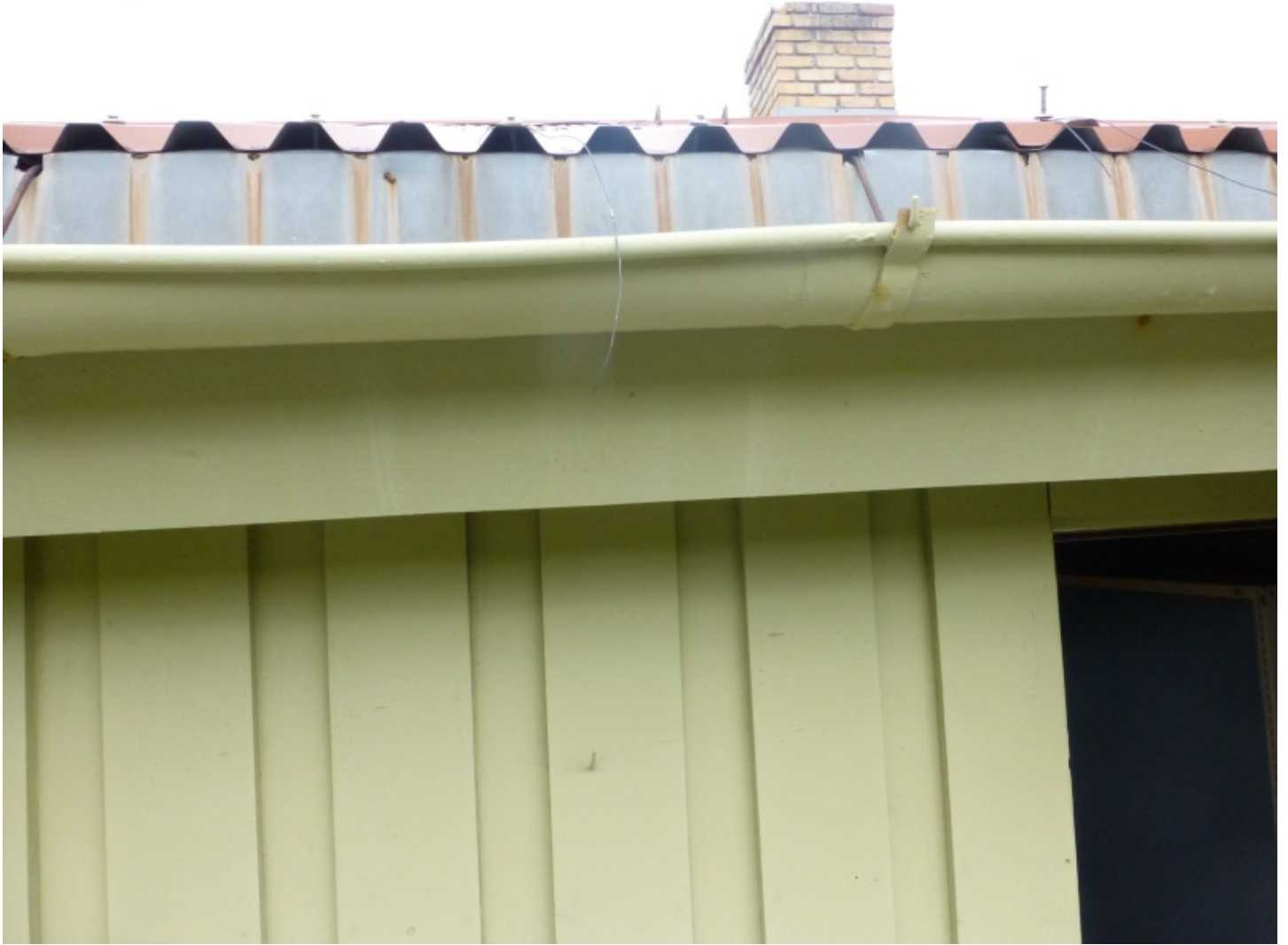
Utsnitt takrenne. Foto Arkitektskap juni 2016
