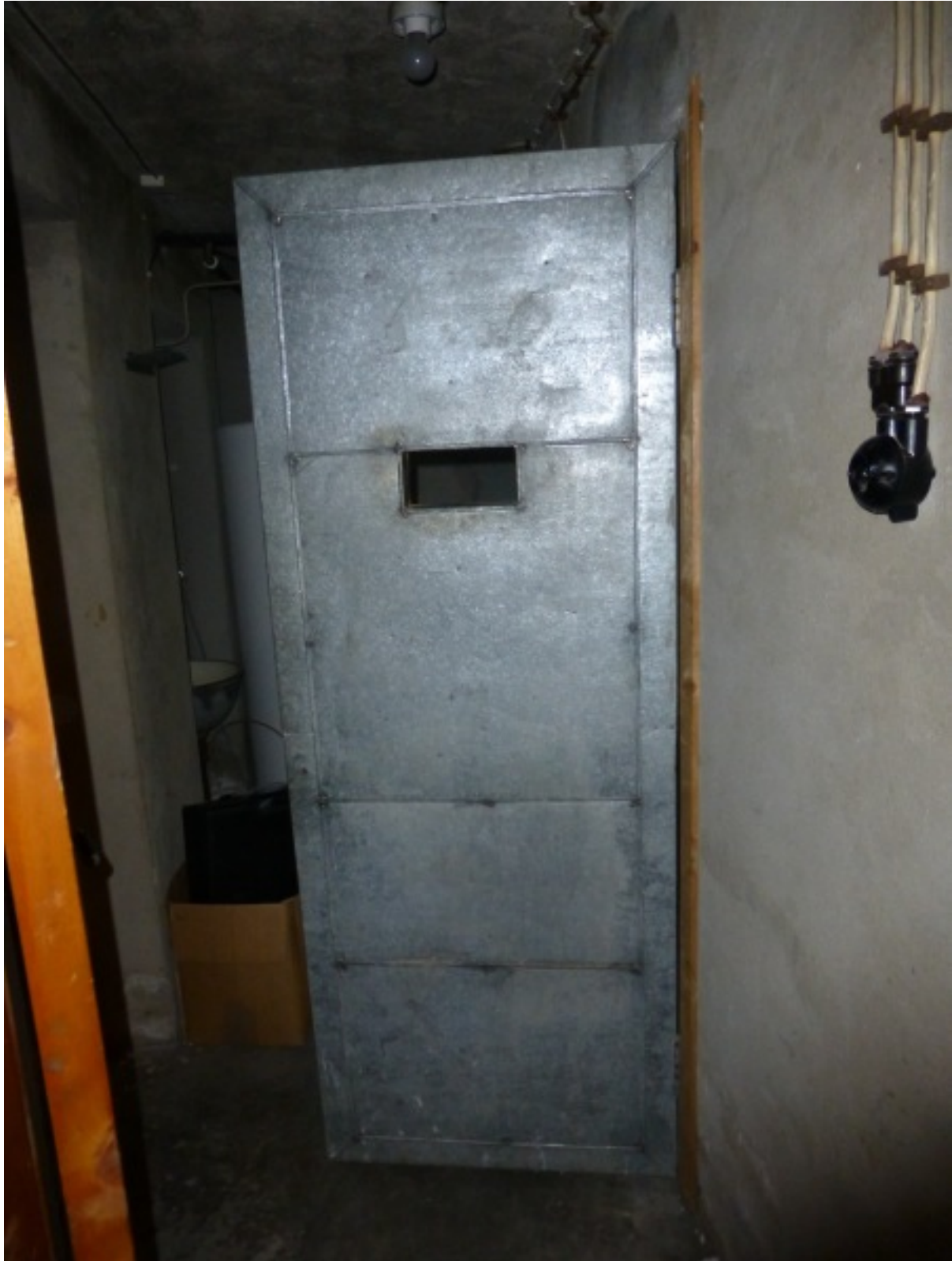
Gjenværende ståldør til fengselscelle. Foto Arkitektskap juni 2016
