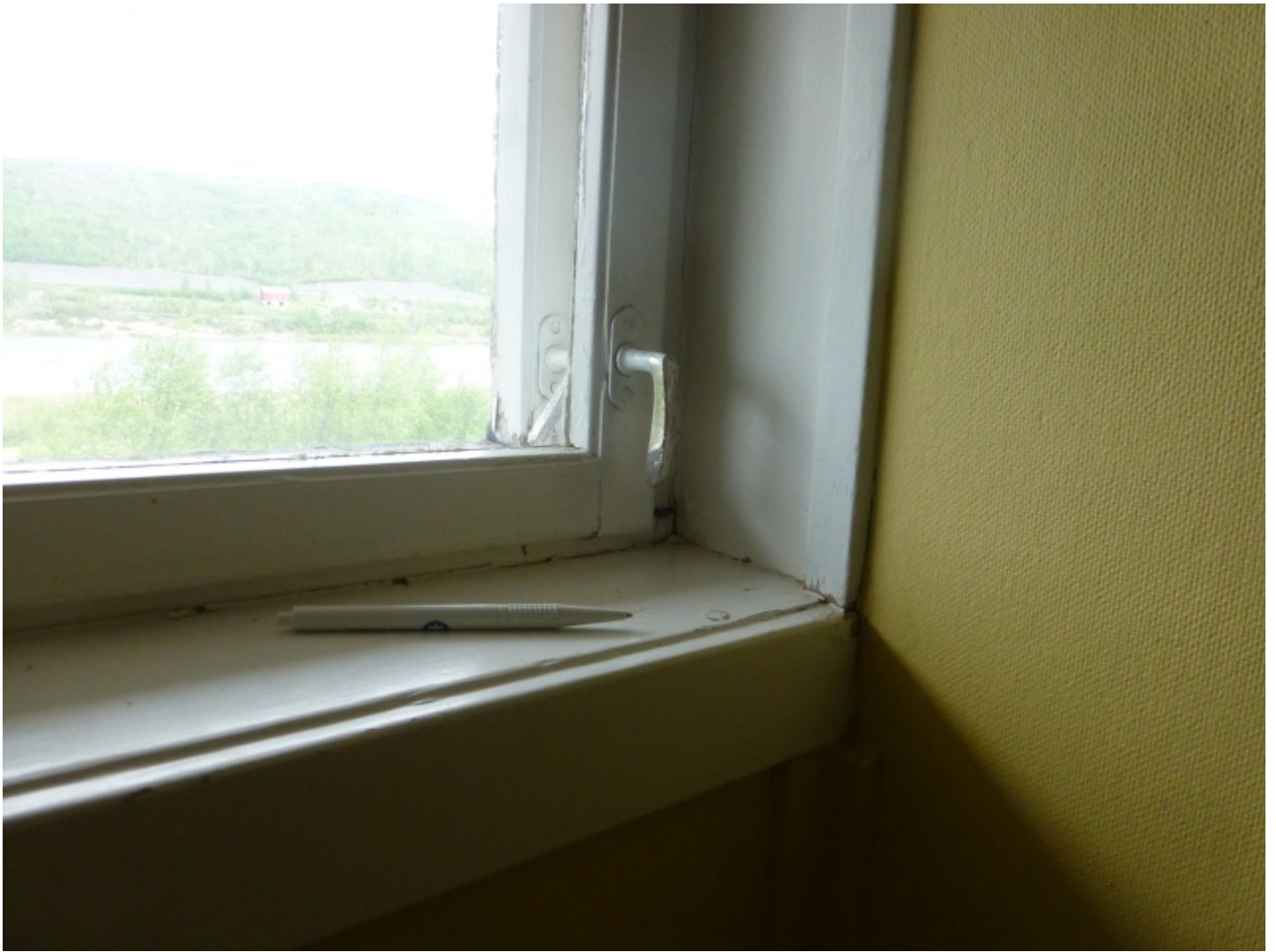
Originale innvendige hasper på vindu i andre etasje bad. Foto Arkitektskap juni 2016
