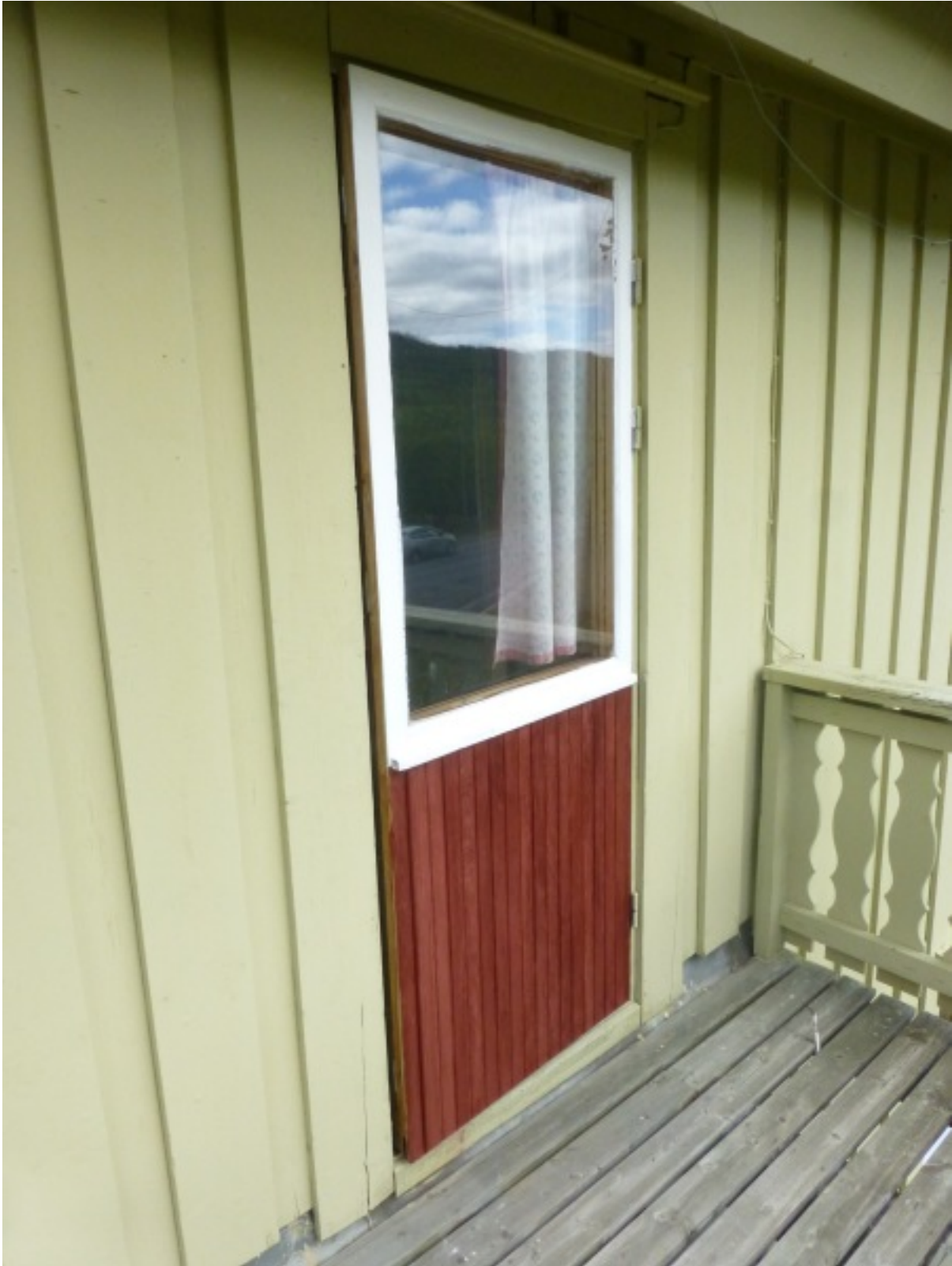
Balkongdør. Foto Arkitektskap juni 2016
